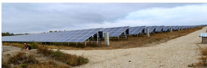
Parc fotovoltaic la Maruntisu
