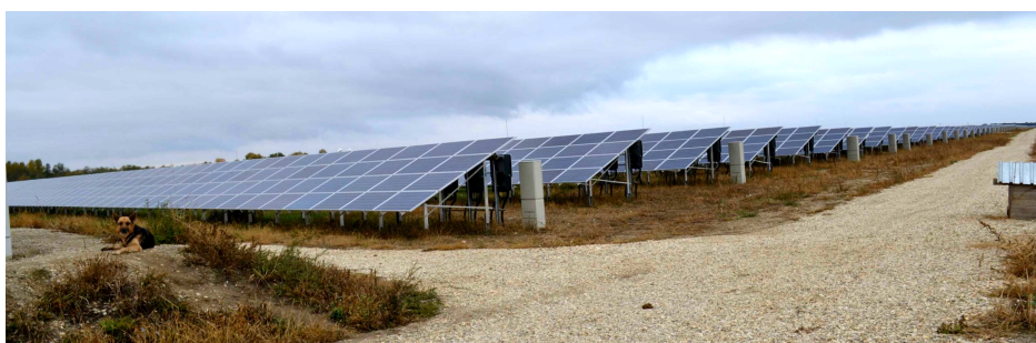
PARC FOTOVOLTAIC LA MARUNTISU
